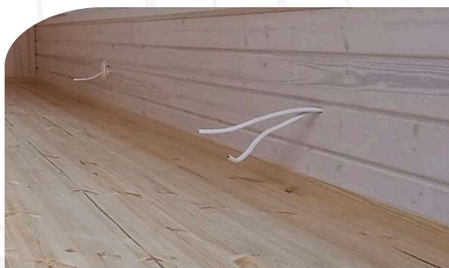
Piharakennus on saatavilla myös perussähköillä, kuten lämmityspatterit, kattovalot ja pistorasiat. Tässä kohteessa asiakas halusi sähköt kytkemättä.
